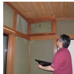
●天井や壁にできたシミを確認
