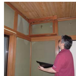
●天井や壁にできたシミを確認
