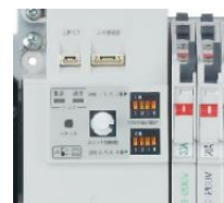
通信計測ユニット実装部
