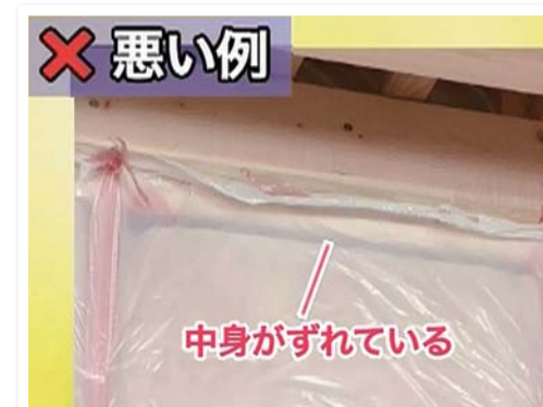
断熱欠損の代表例。上表内の左下図に該当。33%のロス。
