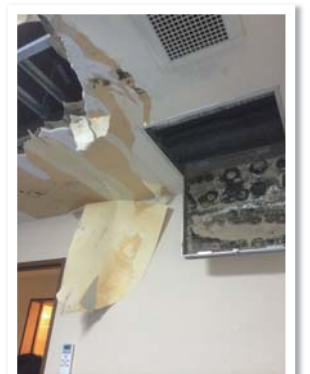
屋根裏で結露した水滴が垂れ、天井裏がカビ一面の被害。断熱方法、断熱仕様とも悪い結果。
